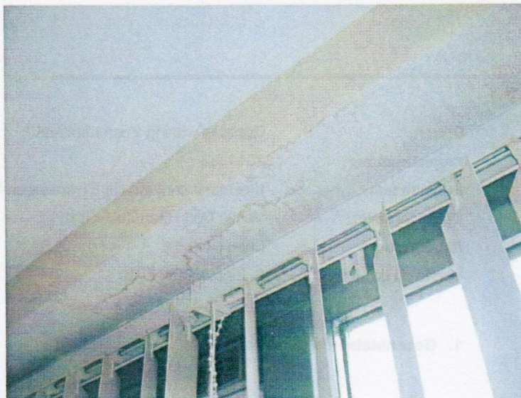
Waterdoorslag boven kozijn
